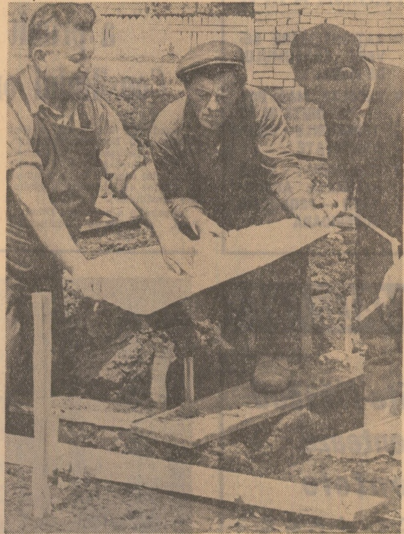
În comuna Cipău, judeţul Mureş, au sosit cărămida, materialele de construcţii, proiectele. Şi primele două familii s-au şi apucat de lucru: cele ale cooperativilor Gheorghe Serban şi Iosif Szasz
