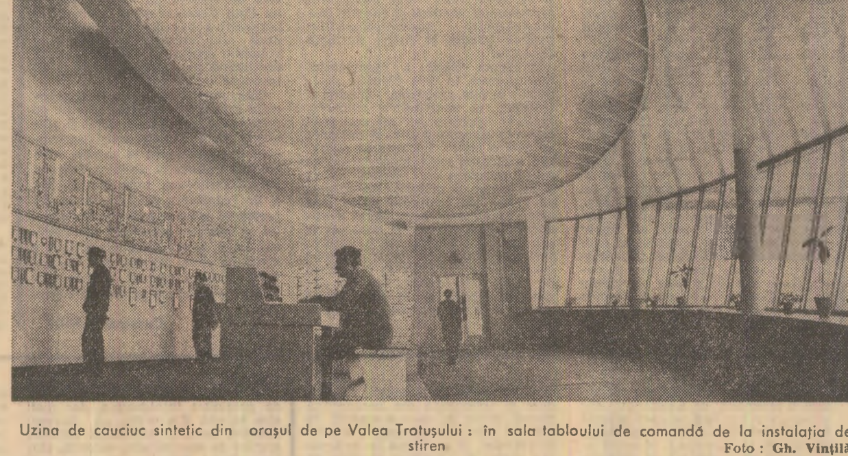
Uzina de cauciuc sintetic din orașul de pe Valea Trațușului: în sala tabloului de comandă de la instalația de stiren. Foto: Gh. Vințilă
