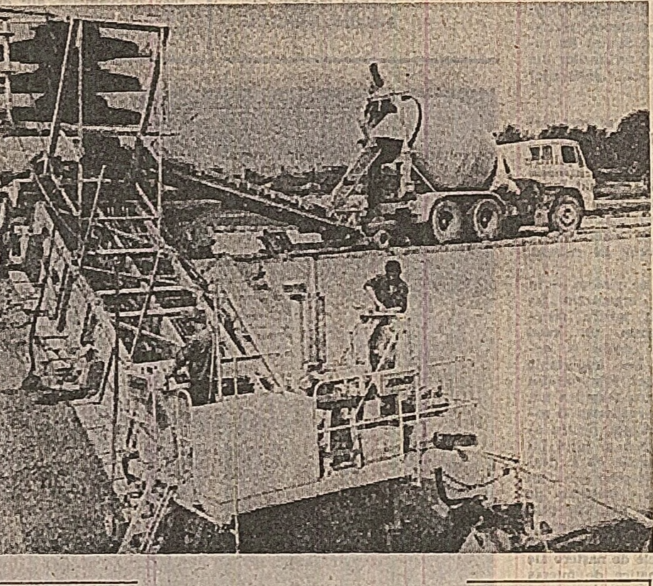
În județul Teleorman se află în curs de construcție sistemul de irigație Olt-Călmățui. Prin realizarea acestui sistem, 32 de unități agricole vor beneficia de apă pentru o suprafață de 46.000 ha. De pe acum a început să prindă contur rețeaua de canale, în lungime de peste 125 km; prin care, ope va fi dirijată în direcția plantelor. În februarie următoare sînt folosite la lucrările de imperfecționare a canalului principal de aducțiune a apei.
