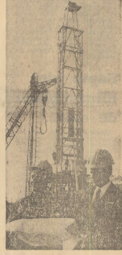
Noua realizare a uzinei „M” (a P.10) în insula petrolieră P-80. Utilajul conceput pentru a executa 16 operații diverse de intervenții, reparatii, punere în producție a sondelor, de adineime pînă la 6 500 m, și de foraj, a fost realizat cu o economie de 12 tone de metal față de proiectul inițial.
