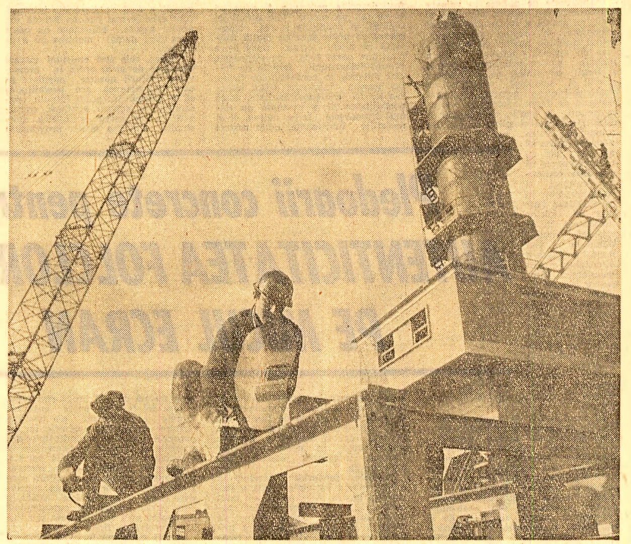
Platforma industrială Tirgoviste. Ritmul intens de lucru — rezultat al bune colaborări dintre constructori, beneficiari, proiectanți și furnizori de utilaje — a avut ca efect devansarea cu 45 de zile față de graficele de execuție a lucrărilor de construcție de la fabrica de var a oțelăriei. În fotografie: echipa de montori condusă de Marin Negriță, formație care și depășește, consecvent, planul de producție.
