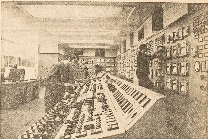
Centrala electrică de termoficare Grozvești din Capitală. Aspect din camera de comandă termică
