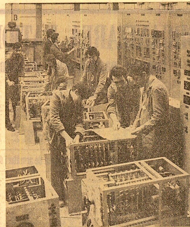
Prestigiul dobîndit de colectivul întreprinderii bucureștene „Automatica” se datorează, desigur, și atenției deosebite acordate calității ireproșabile a produselor realizate. Iată un moment semnificativ din timpul verificării unui nou lot de panouri de comandă automată în secția a IV-a de montaj electric
