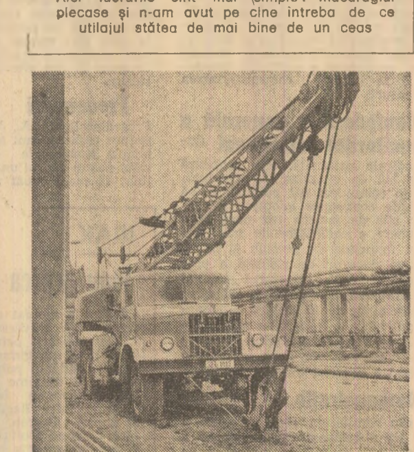
O altă macara era doar simplă plesă de decor pe șantier: se defectase
