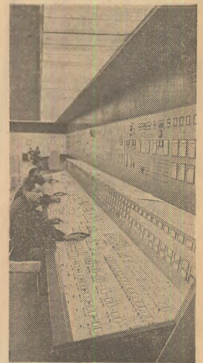
În camera de comandă a termocentralei Iplaița — Craiova
