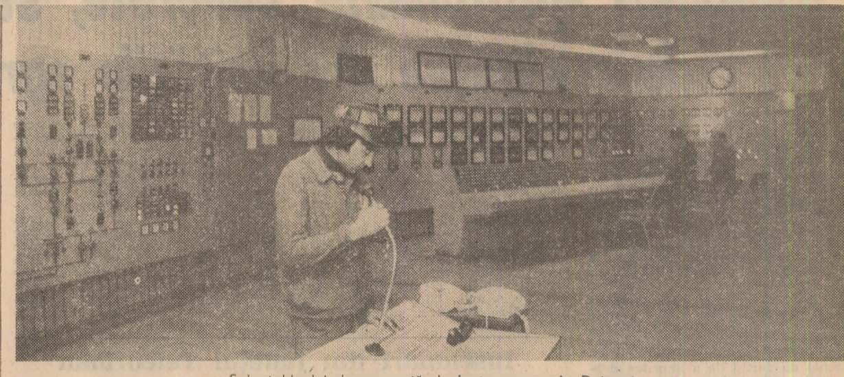
Sala tabloului de comandă de la termocentrala Doicești
