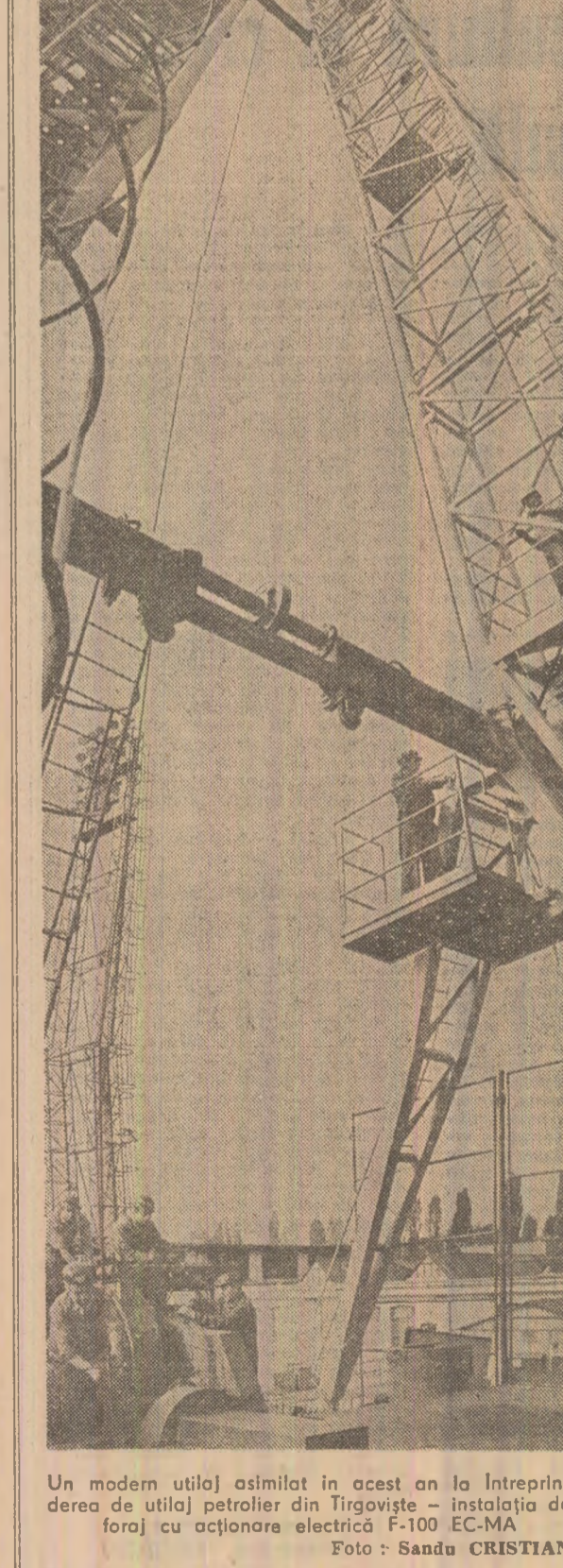
Un modern utilaj asemilat în acest an la Întreprinderea de utilaj petrolier din Tîrgoviște - instalația de foraj cu acționare electrică F-100 EC-MA Foto: Sandu CRISTIAN
