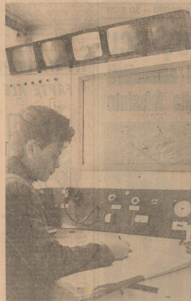
Aspect din camera dispeceratului de la I.M. Paroșeni. Foto: S. Cristian
