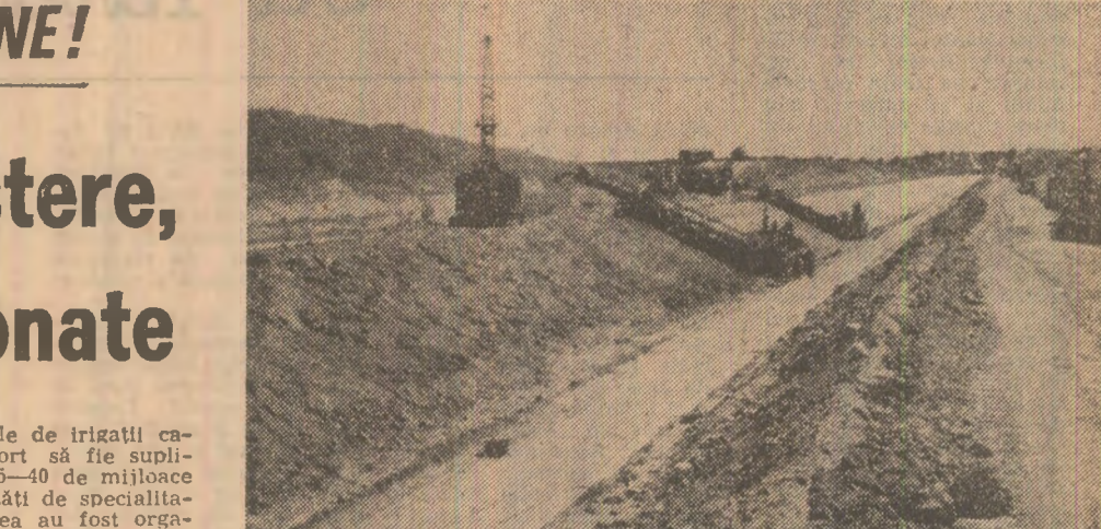
Ritmul de lucru a crescut mult pe șantierele de irigații din județul Buzău. În imagine: aspect de la impermeabilizarea canalului magistral — C — Vest, din sistemul Cîmpia Buzăului
