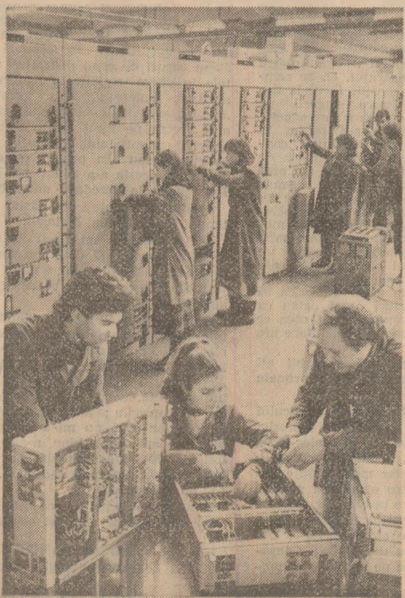
ECHIPAMENTE DE AUTOMATIZĂRI ÎN DEVANS
