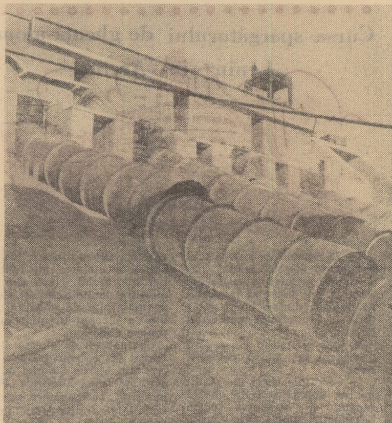
Pe Bistrița, mai jos de Hidrocentrala „V. I. Lenin”, sînt în plină construcție 7 din cele 10 hidrocentrale prevăzute în planul de amenajare a acestui riu. În fotografie, un aspect al hidrocentralei Roznov I.
