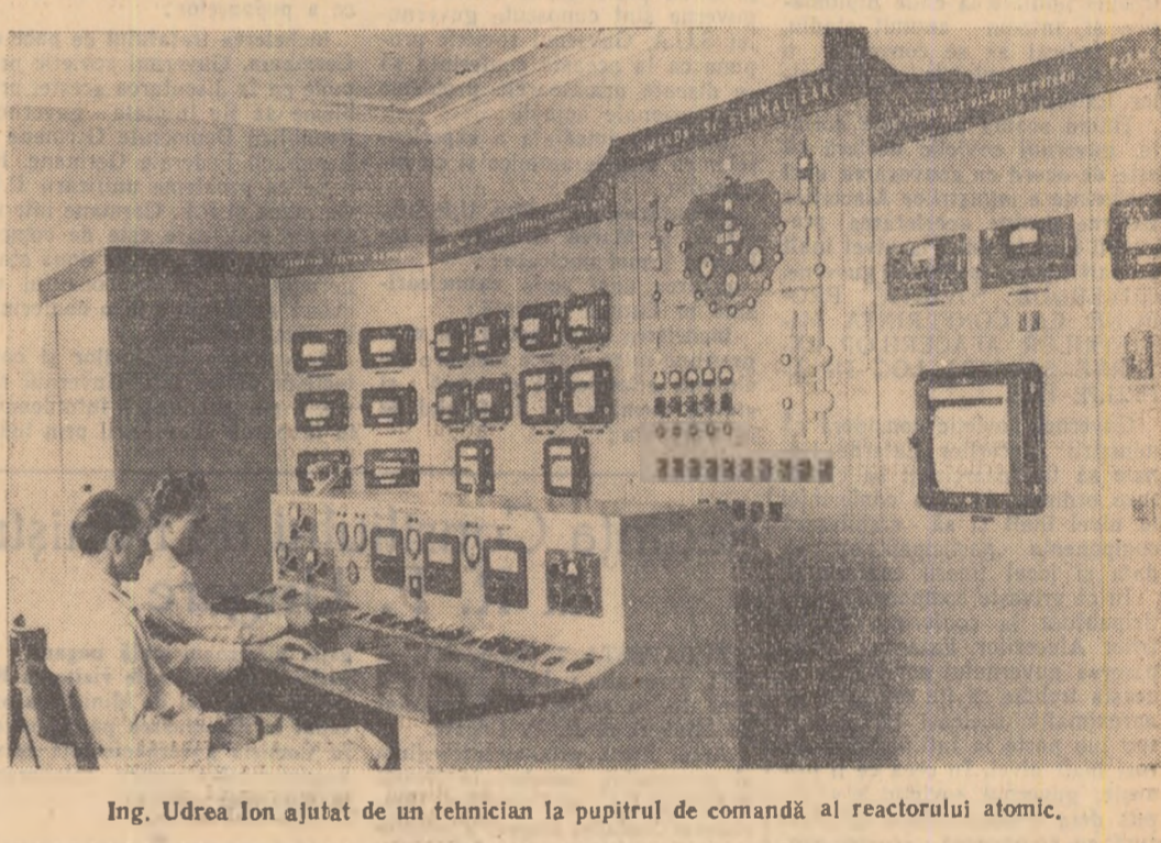
Ing. Udrea Ion ajutat de un tehnician la pilotul de comandă al reactorului atomic.
