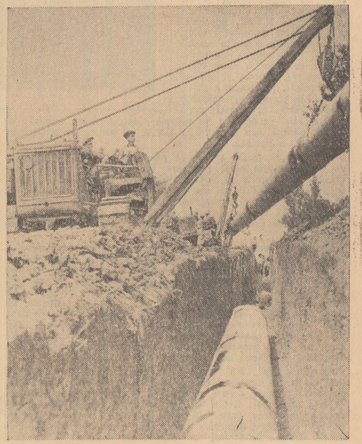
Muncitorii de pe șantierul Oltuz, (noua conductă de gaz metan Nadeș-Onesti), au montat pînă în prezent peste plan peste 3.000 metri liniari de conductă și se străduiesc ca — împreună cu celelalte șantiere — să termine planul înainte de termen, adică înainte de sfîrșitul anului. În fotografie: un aspect de la lănsarea conductelor
