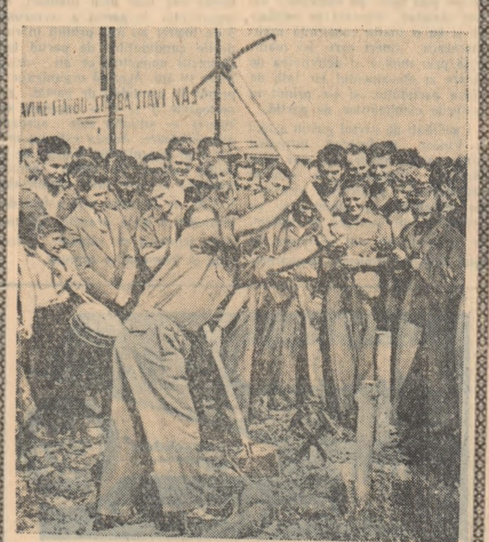
Membrii Uniunii Tineretului Cehoslovac au hotărît să construiască o mină modernă în cel mai mare bazin carbonifer al R. Cehoslovace — regiunea Ostrava. Imaginea noastră reprezintă un aspect de la începerea lucrărilor de construcții.
