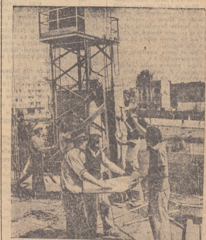
Pe șantierul de locuințe pentru muncitorii Rafinării nr. 7-Brazl, aflat în centrul orașului Ploiești, se află în construcție 5 blocuri cu 162 de apartamente. În fotografie: Iată cîțiva constructorii urmărind pe planuri stadiul lucrărilor. Foto: AGERPRES
