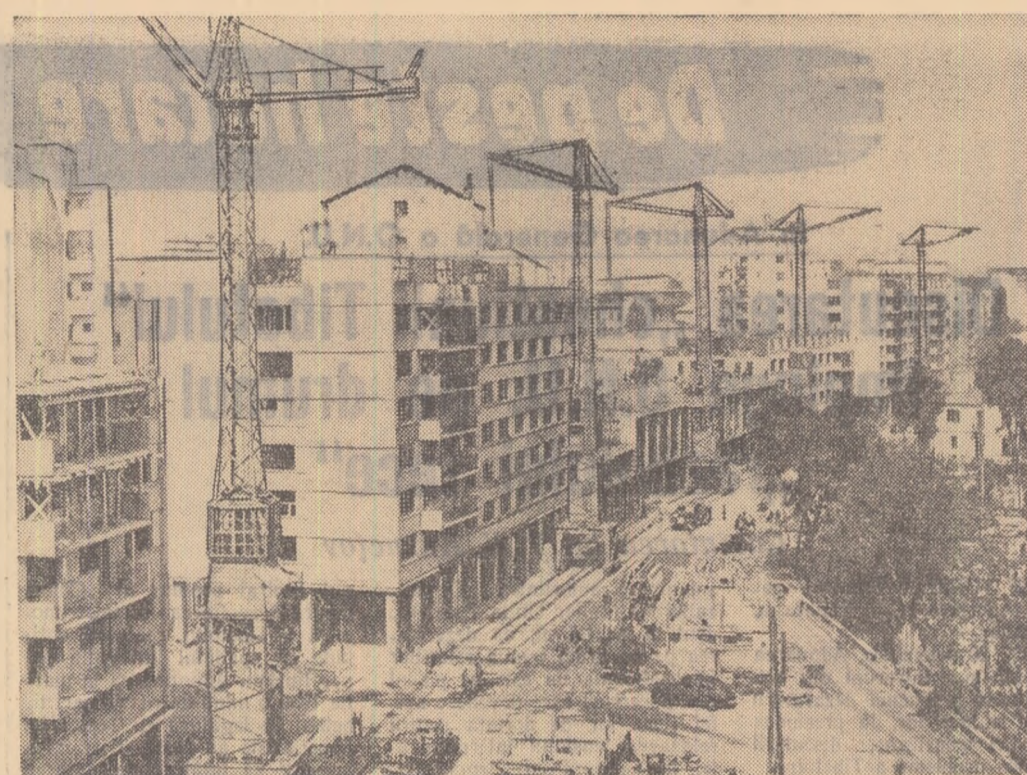
Blocurile ce se înalță în piața din spatele Palatului Republicii din București capătă contururi din ce în ce mai precise.
