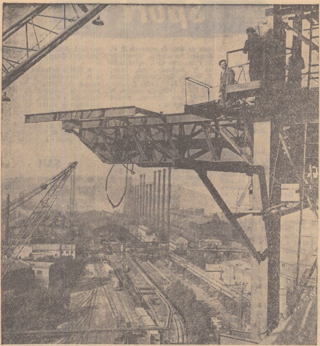
Noul furnal al Combinatului Kuznezki construit de comsomoliști și terminat la 7 Noiembrie.
