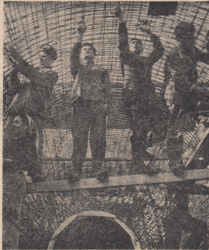
Aspect de pe șantierul barajului Trakietz din R. P. Bulgaria. Echipa de constructori condusă de D. Kotliar la lucru.
