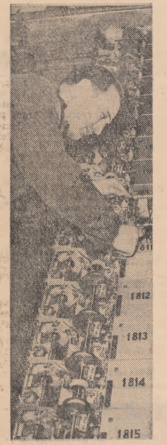
Lucrînd la restabilirea unui de-aranjament în centrul telefonic automată Bucuresteană. Foto: AGERPRES
