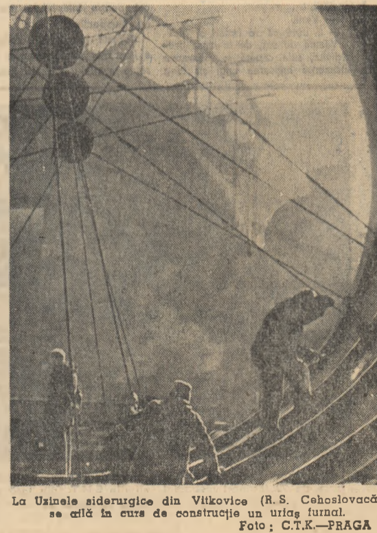
La Uzinele siderurgice din Vitkovice (R.S. Cehoslovacă) se află în curs de construcție un uridag turnal. Foto: C.T.K.—PRAGA
