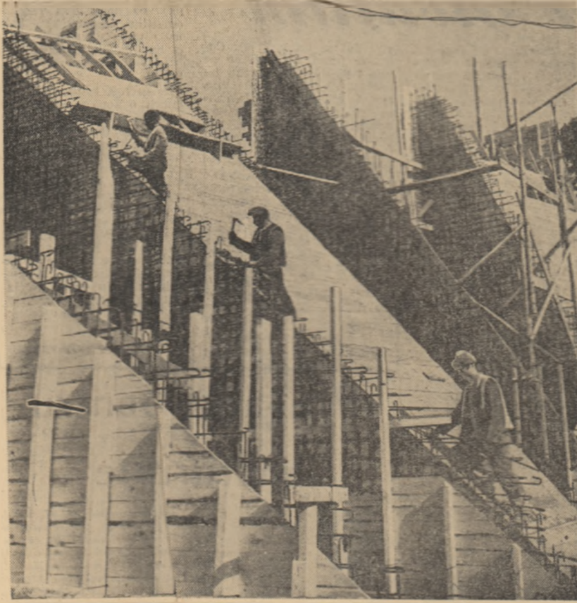
Aspect de pe șantierul Hidrocentralei Roznov II, una din hidrocentralele aflate în construcție pe Bistrița.
