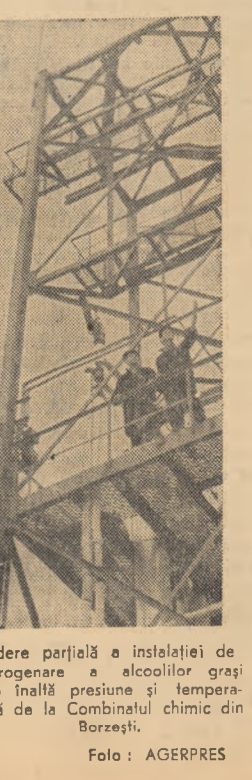
Vedere parțială a instalației de hidrogenare a alcoolilor grași sub înaltă presiune și temperatură de la Combinatul chimic din Borșești.
