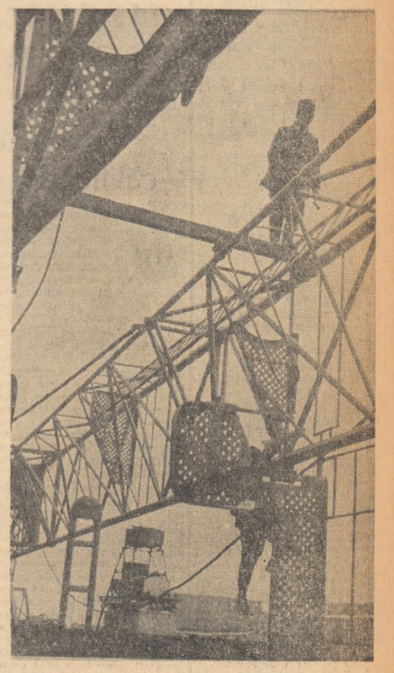
La Uzina „1 Mai”-Ploiești se lucrează la scheletul unei noi instalații pentru sondele de foraj.
