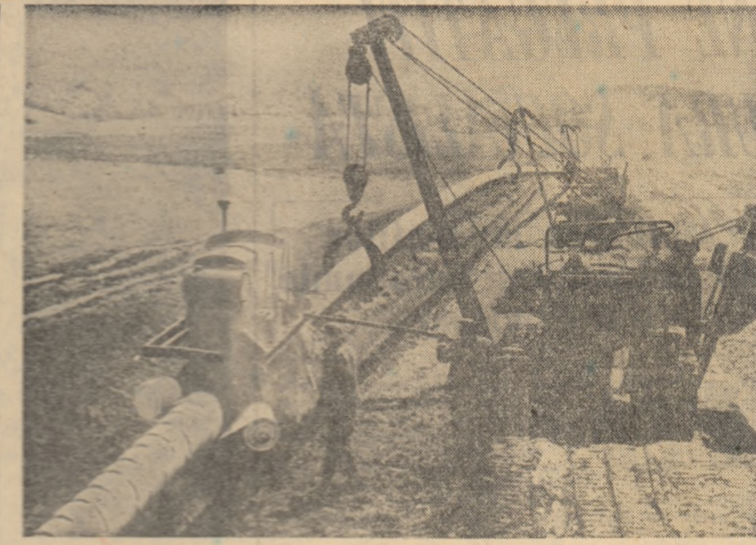
Lucrările pentru construirea conductei de gaze Ordjonikidze-Tbilisi (R.S.S. Gruzină). Conducta va avea peste 200 km.
