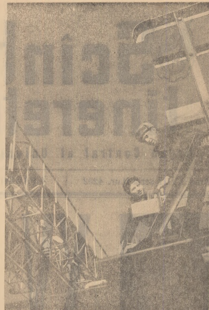
Realizarea planului anual cu două zile înainte — iașă engajamentul celor doi montajeri în muncă (Dumitru Rașea și Sîraș Ciolan) de la întreprinderea de poduri metalice și prefabricate de beton-Pitești.
