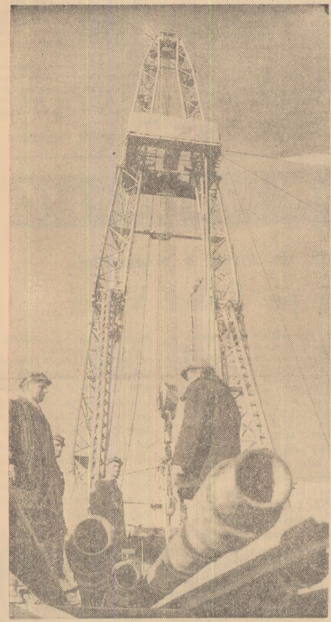
Pe terasa instalatilor scrie: „Fabricat în R.P.R.” Locul unde forează — Oltenia...
