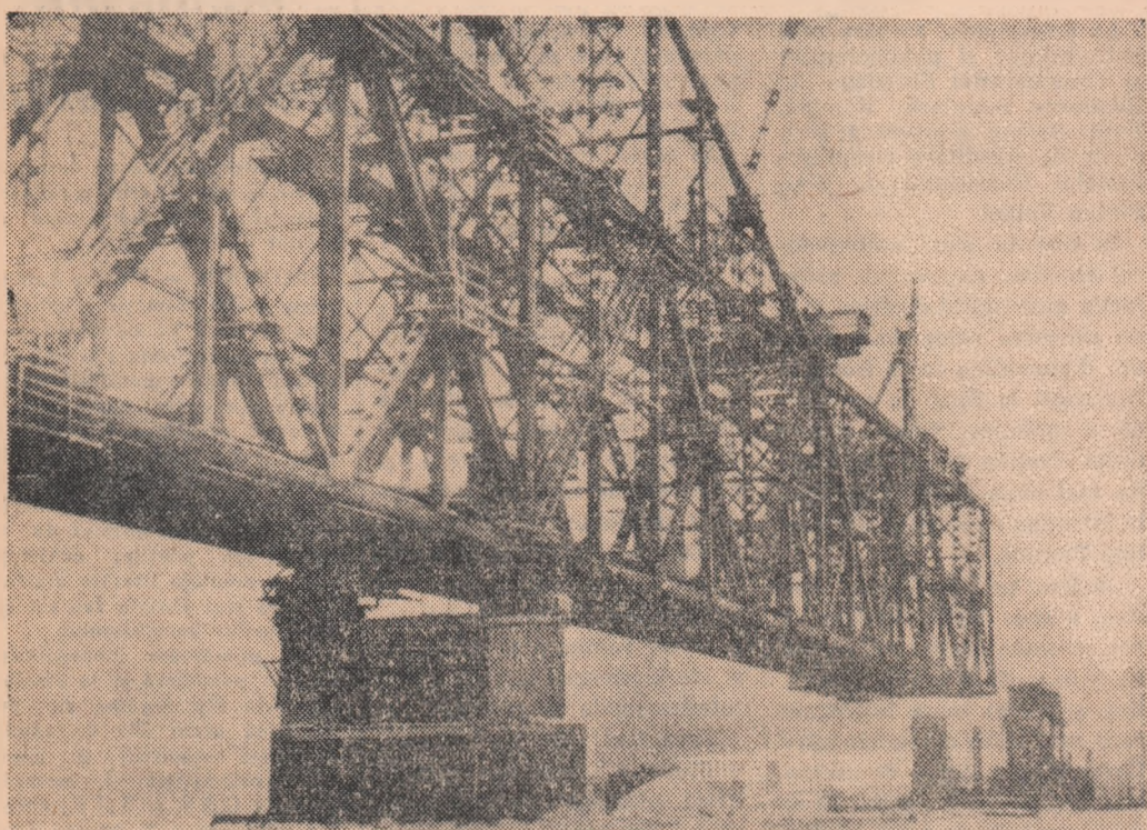
U.R.S.S.: Aspect din timpul construcției noului pod pe râul Dvina de la Arhanghelsk.
