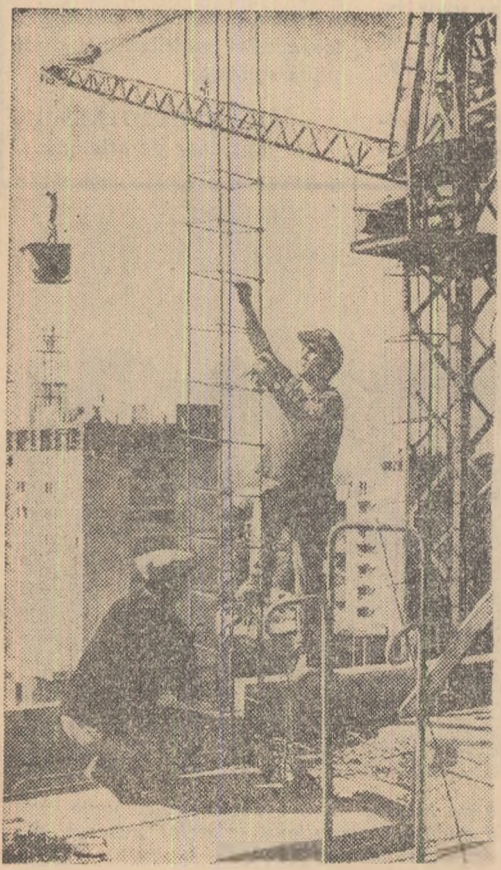
Muncitorii de pe șantierul 3-Toporași lucrează intens la înălțarea noilor blocuri de pe șoseaua Giurgiuului din Capitală. În fotografie: tinerii betonisti, din echipa lui D. Șerban, lucrând la planșul etajului 7 al blocului nr. 11. Foto: AGERPRES
