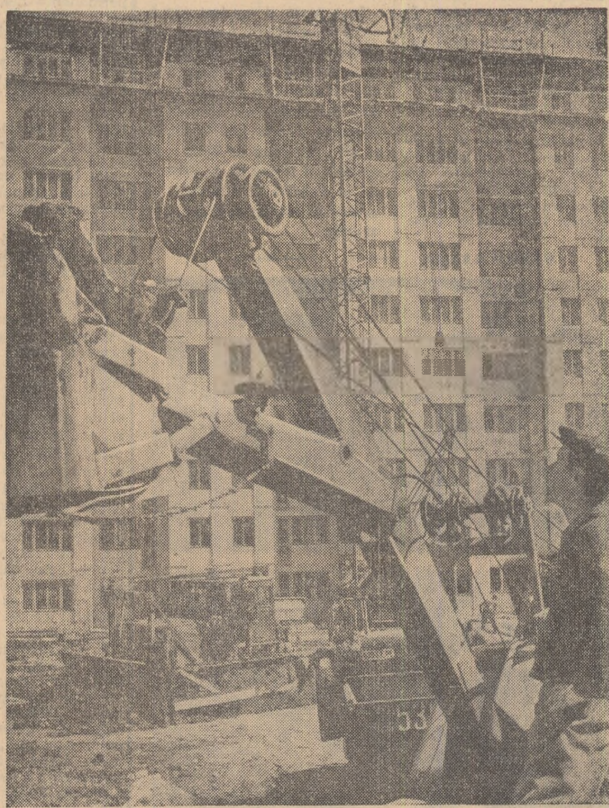
O imagine obișnuită pe șantierul Oneștiului. Alături de schelele semețe, excavatoare, buldozere, macaralele — într-un cuvînt un grad înalt de mecanizare. Foto: S. VIOREL
