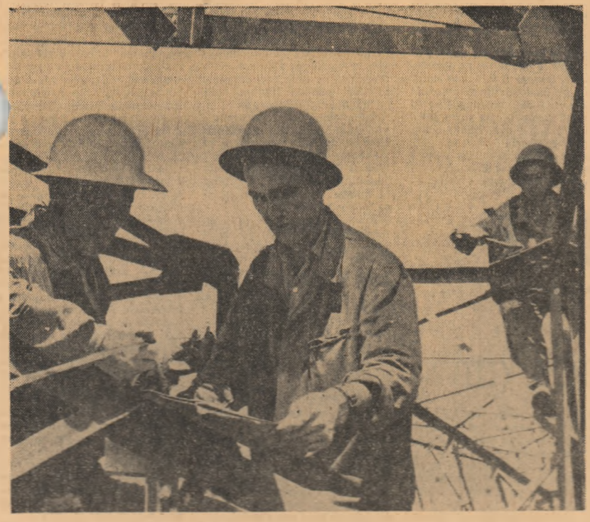
Montorii Radu Ciuru, Petre Gheorghiu și Tudor Chiriță de la Întreprinderea de construcții, montaje și prefabricate I.C.M.P. — atelierul Cooperii lucrează la montarea utilajelor de înaltă tensiune de 220 Kv. Foto: AGERPRES
