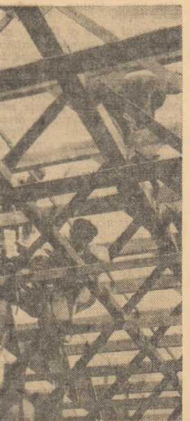
Echipele conduse de Filip Dumitru și Bazavan Constantin, de la Santerul naval Giurgiuu lucrînd la monajul celui de-al 15-lea ponton de acostare
