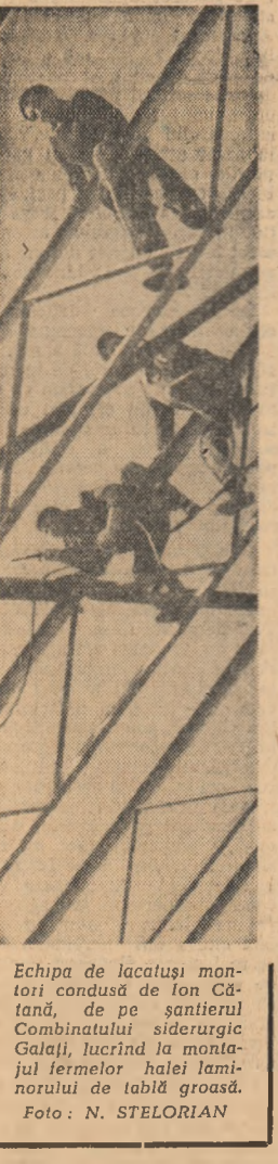
Echipa de lucruși montori condusă de Ion Căntănu, de pe șantierul Combinatului siderurgic Galați, lucrînd la montajul ferelor halei laminorului de tablă grosă. Foto: N. STELORIAN
