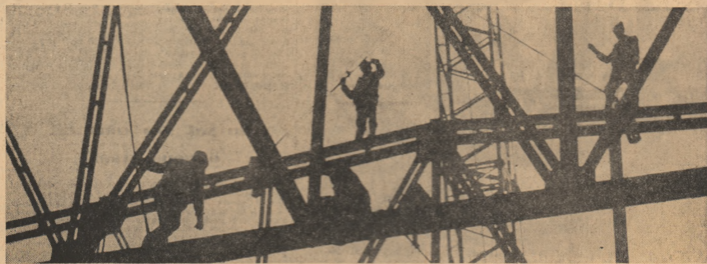
Uzina de aluminiu Slatina. Se montează fermele metalice la hala a II-a de electroliză
