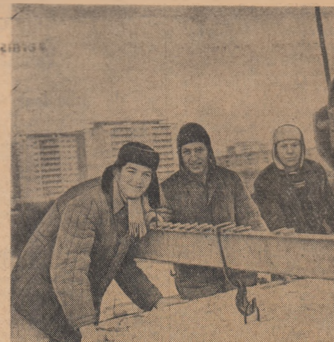
Tinerii pe care-i vedeți în fotografie fac parte din brigada de constructori a lui Simion Heltner de pe șantișul nr. 2 Bercești-Sud. Lucrările electrice de ei primesc calificative bune
