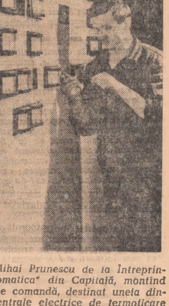
Ulemistul Mihai Prunescu de la Întreprinderea „Automatică” din Capitală, montînd un panou de comandă, destinat unelă dintre noile centrale electrice de termocentrale. Foto: F. DOBRESU
