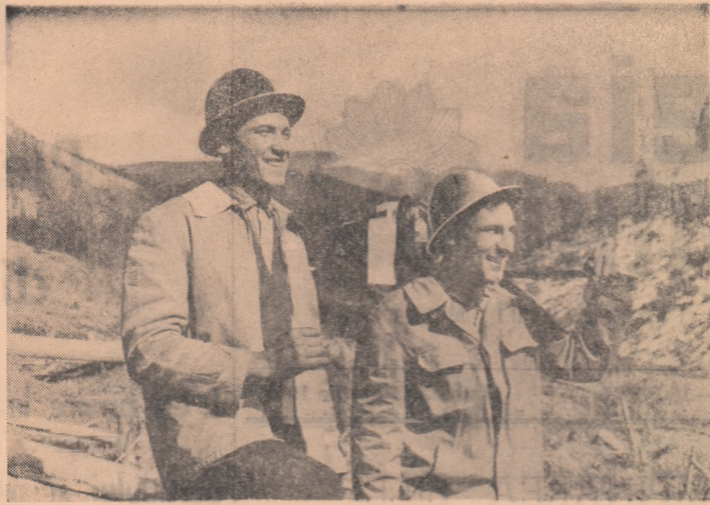
Echipa de doboritori compusă din maestrul Căndrea Gh. și ajutorul său Căndrea Nicolae se numără printre echipele de doboritori evidențiate în sectorul Coșna
