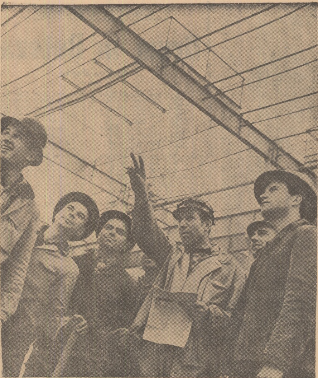
Echipa de lăcătuși montori a lui Nazarie Costică, echipă evidențiată pe șantierea Combinatului siderurgic „Gheorghe Gheorghiu-Dej”-Galați, lucrează la construcțiile metalice de la turnătorii mixte. Din echipă mai fac parte și tovarășii: Iulian Jugăreanu, Dumitru Munteanu, Alexandru Miluceanu, Constantin Zovate, Gheorghe Ursoiu și Vasile Mișlea.
