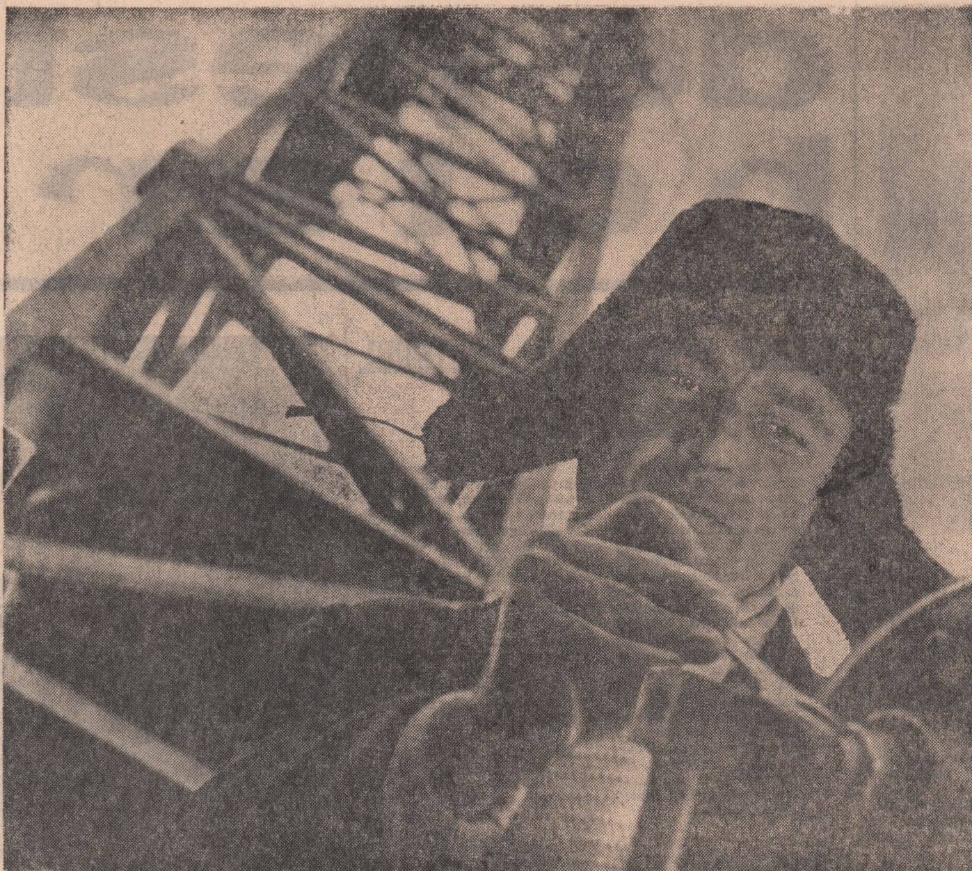
GHEŁASE EUGEN este mecanic de macara. Dar el este, în același timp, unul dintre constructorii în minile cărora stau — dacă vrei! — înseși destinele șantierului, sau cel puțin o bună parte din ele. Vibrosoneta comandată de macaraua sa ținează în apele fluviului, în stâncile din adâncuri, palplanele de oțel ale celulelor batardoului.
