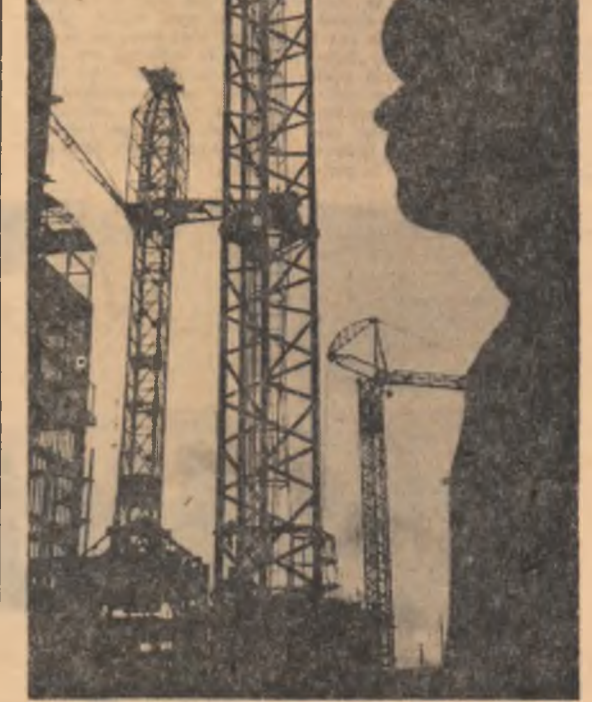
„Protituri paralele” (La termocentrala Craiova)
