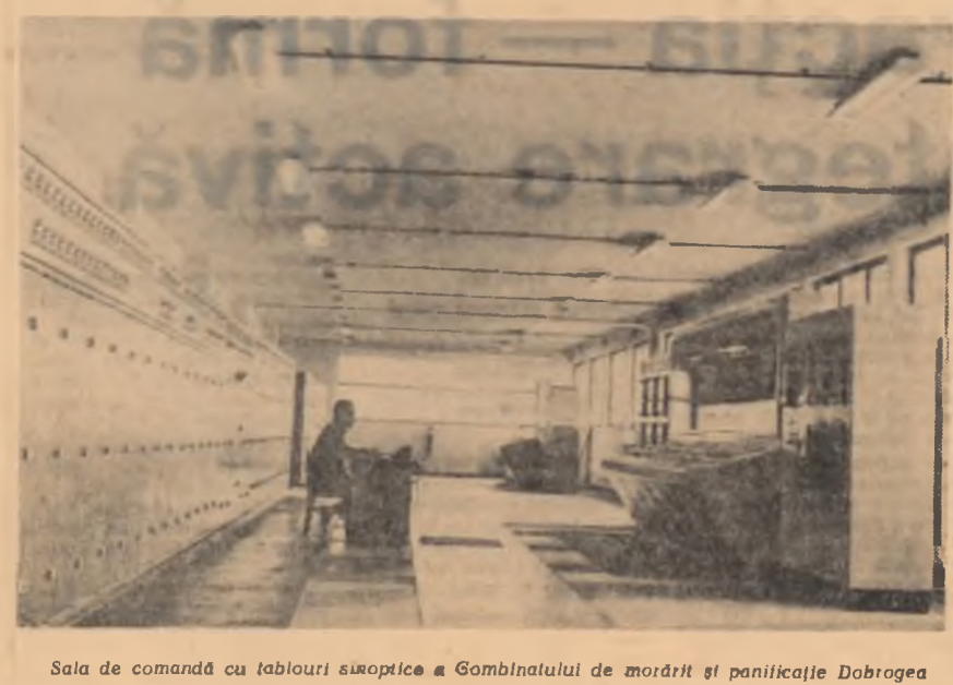
Sala de comandă cu tablouri optice a Gombinatului de morărit și panificație Dobrogea
