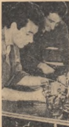
Întreprinderea industrială de stat „Automatca”. Se lucrează în tabloul de comandă pentru instalația de încălzit și iluminat vagoane de căldură.
