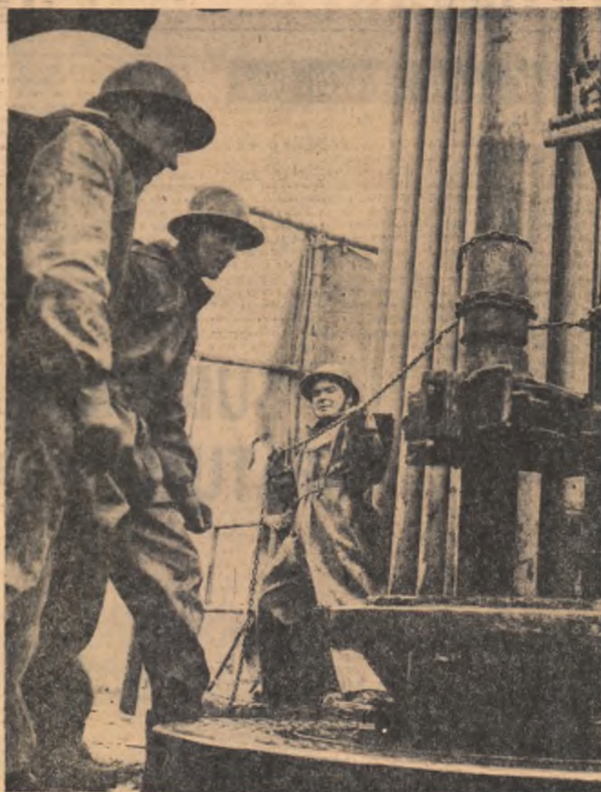
Aspect de lucru din cadrul șantierului Chiaia, regiunea Ploiești. Sondarii din brigada condusă de Stanca Ion Lucind la schimbarea sapei, folosind penele pneumatice și înșurubarea pașilor de prăjini cu lanț calibrat (metodă ce le permite o depășire cu 30 la sută a planului). Foto: AGERPRES
