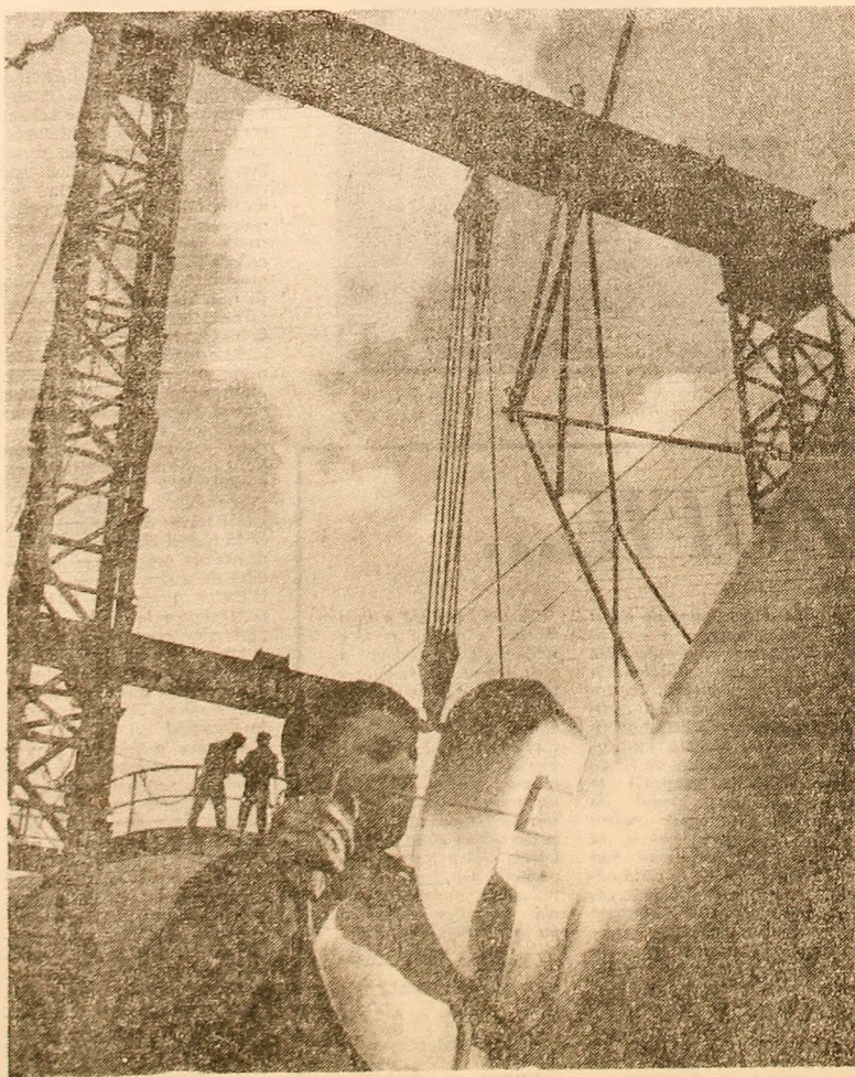
Șantierul Combinatului siderurgic Galați. Se lucrează la cele două rezervoare de oxigen lichid necesare alimentației cuptoarelor oțelării
