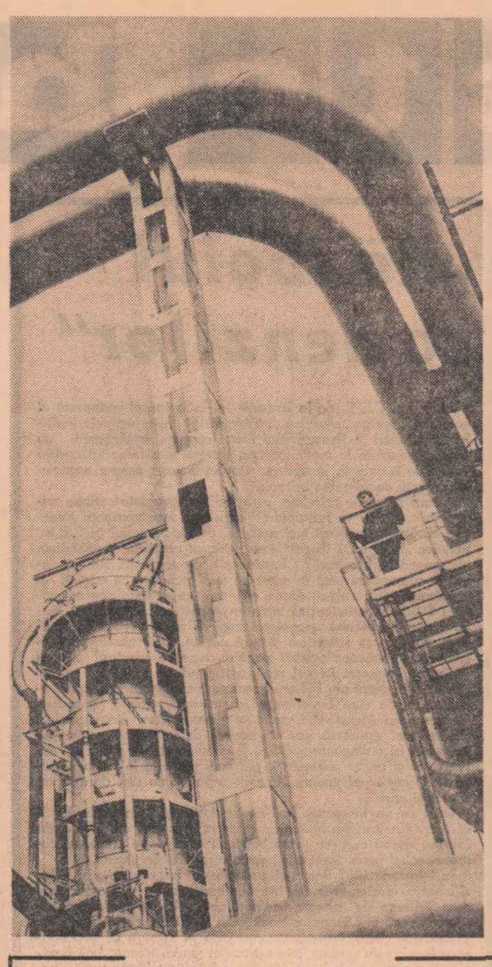
Rafinăria Ploiești. Anul trecut a intrat în funcțiune o instalație de distilație atmosferică și în vid cu o capacitate de 2000 tone zilnic, care produce uleiuri spectabile. În fotografie: vedere parțială a instalației Foto: Agerpres
