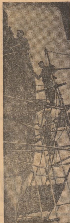
Șantierul naval Oltenița. În lucru, un nou vas care va fi lansat la apă
