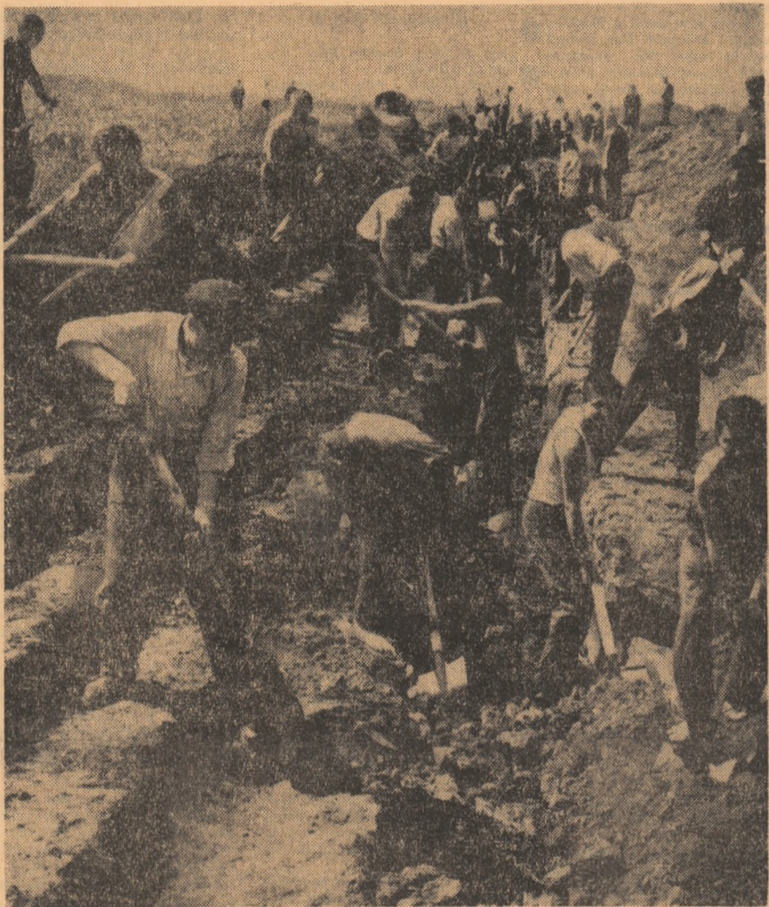
Pe șantierul de trigații Giurgiu—Oinacu — Remuș, fotoreporterul O. PLECAN a consumat ultimul cișeu...
