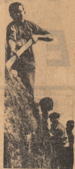
Lucrările de irigații prefac în tînsul ogoarelor în șantierul de muncă patriotică. Foto: O. PLECAN
